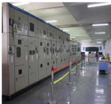
变配电技术实训室
