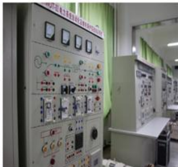
继电保护及电力系统自动化实训室
