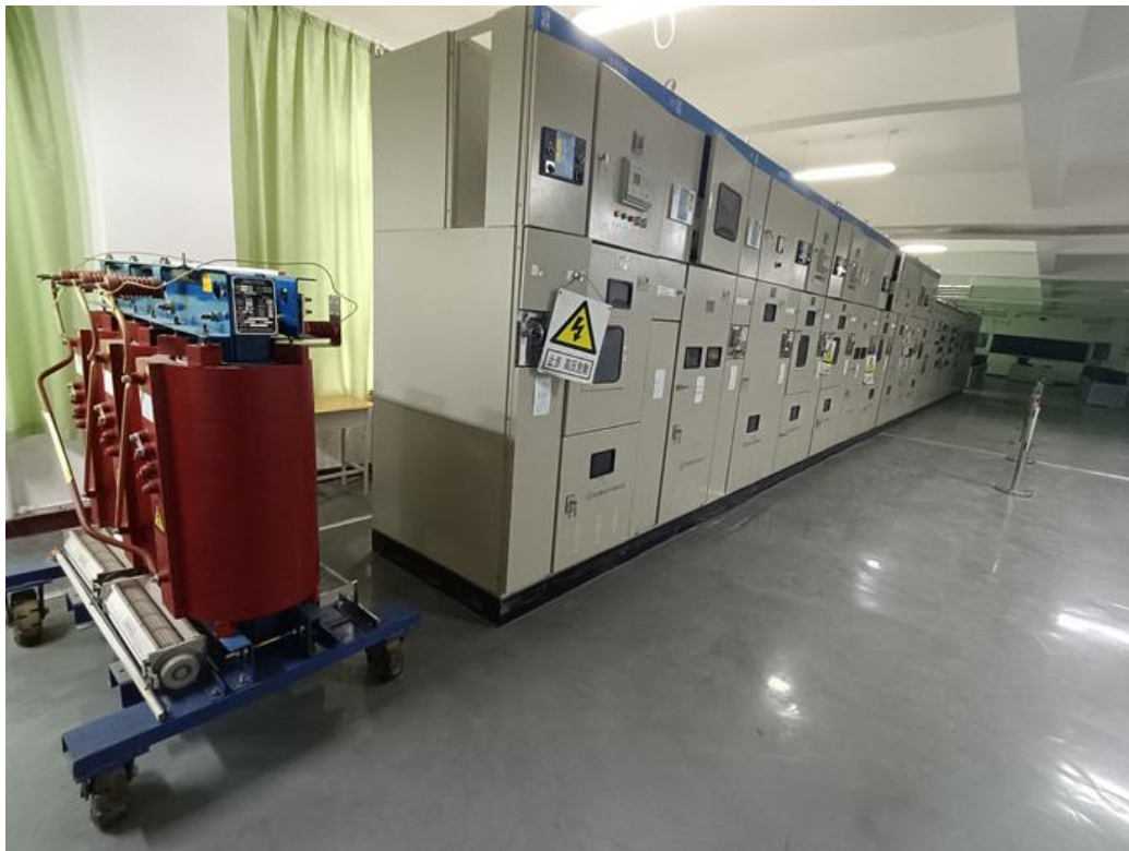
能源动力工程分院供配电实训室
