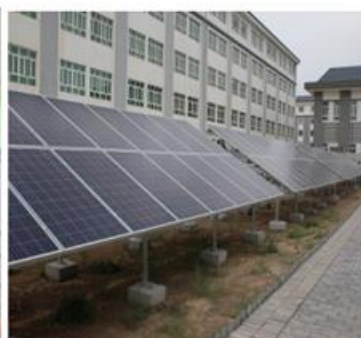
太阳能光伏电站
