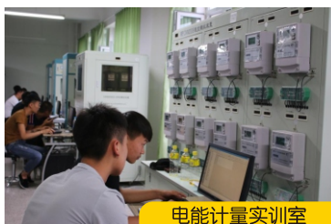
电能计量实训室
